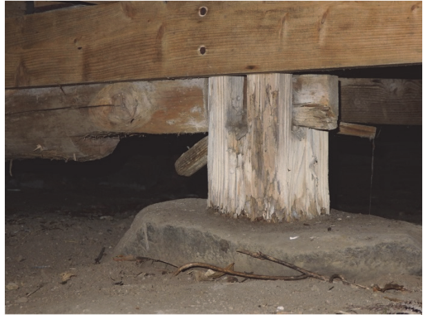
主屋・土間境, 北縁・室境柱下部 腐朽
