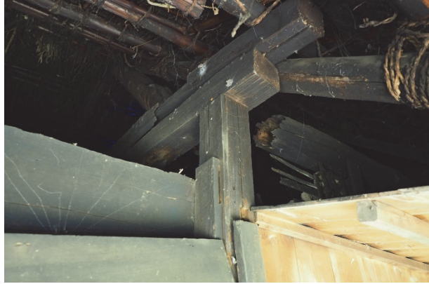
座敷部小屋組東端 梁北側・桁折れ 北から見る
