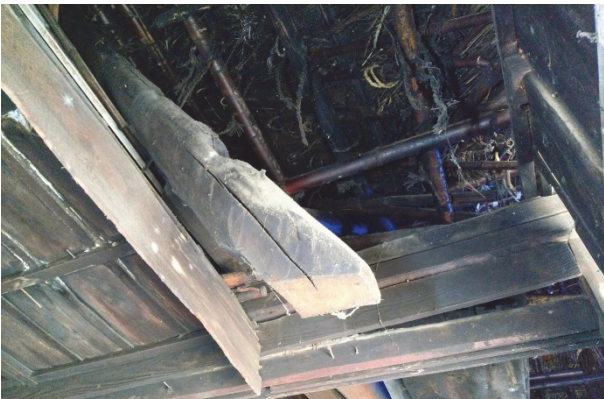
座敷部・土間部境南扱首 端部はずれ
