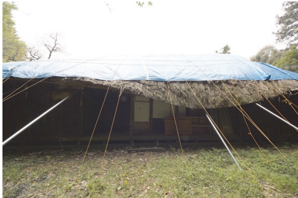
屋根北側 軒の下がり
