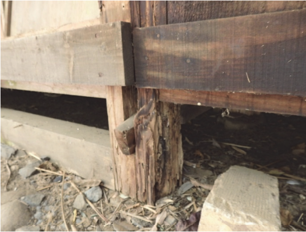
8 畳間・10 畳間境北面柱下部 腐朽
