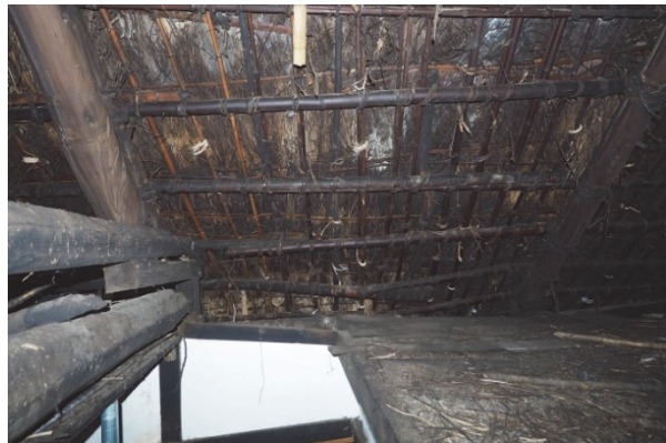
座敷部・土間部境北面 ヤナカたわみ
