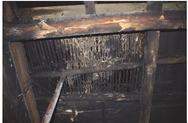
土間囲炉裏上 腐朽・汚れ
