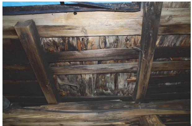
東下屋野地板 腐朽
