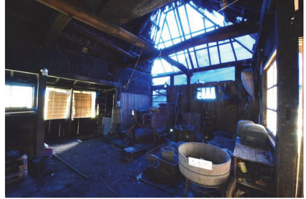
土間部南面中から 茅の落下
