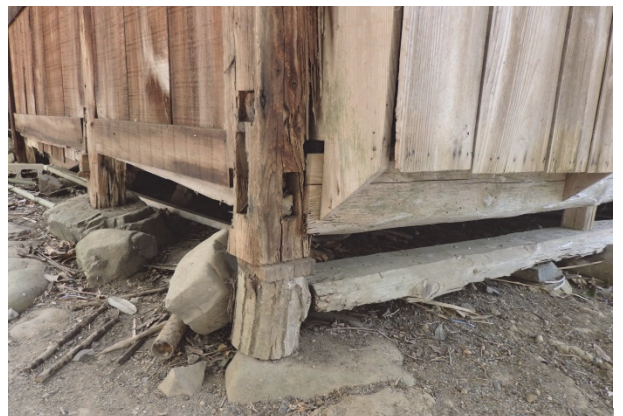
北西角 柱・土台 腐朽
