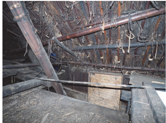
接統部 南桁首の落下（桁首端部仕口ないよう）
