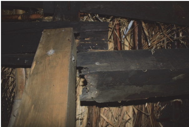
北側縁座敷部・土間部境 桁はずれ
