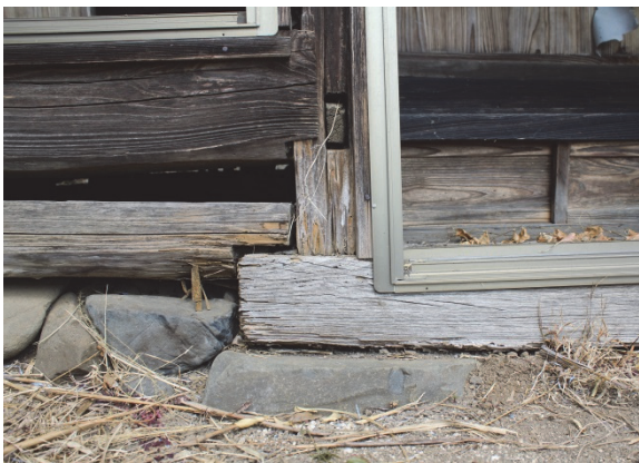
座敷部南面土台 風食
