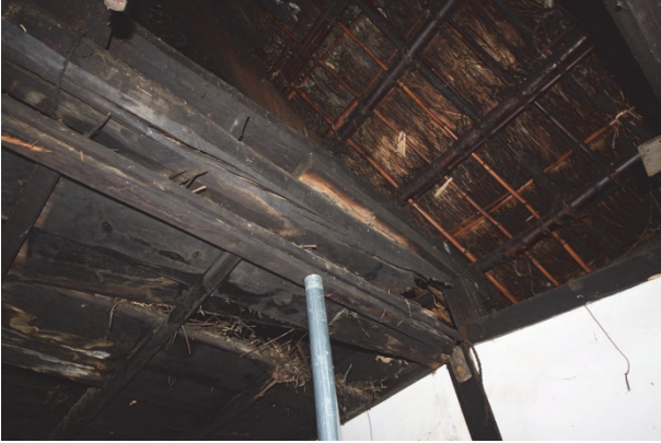
座敷部小屋組東端 梁北側折れ
