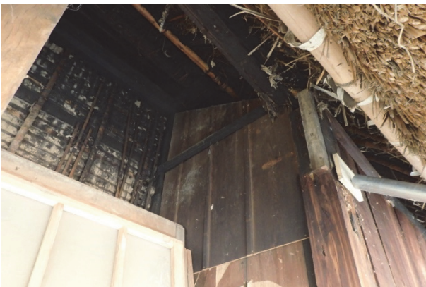
北縁西端 土壁 剥落
