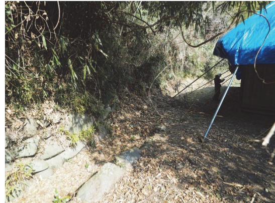
生家背面 土砂崩れ
