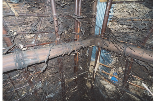
座敷部棟 茅の落下
