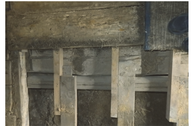
10 畳間西側 床梁 空洞
