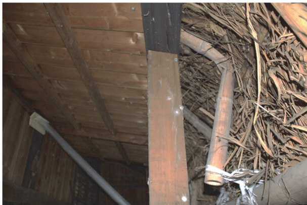
北側縁軒 垂木の折れ
