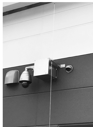
▲外部アンテナ
