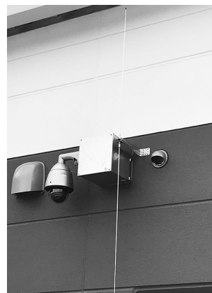
▲外部アンテナ
