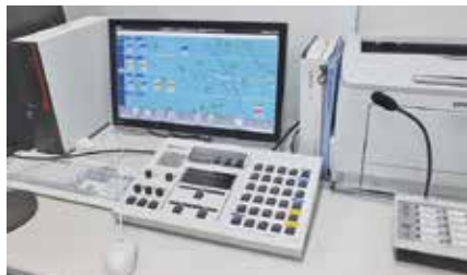
防災行政無線設備
