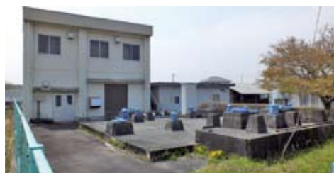
老朽化した石塚浄水場
