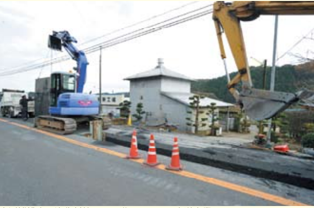
生活雑排水の浄化対策として進められる下水道事業
