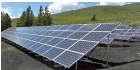
太陽光パネル
